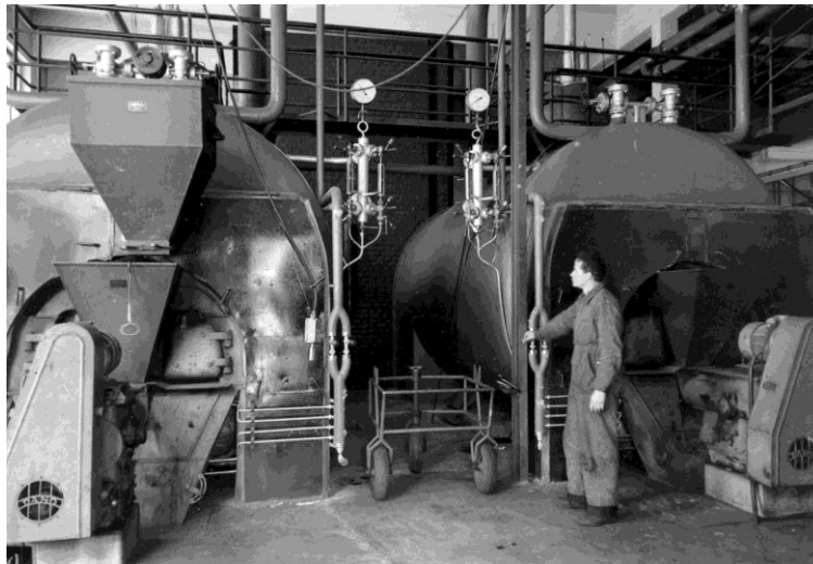
Sairaalan pannuhuone ja lämmittäjä Matti Sutelainen
